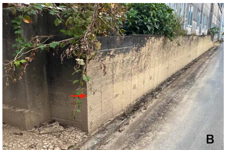
図3 最大浸水深(図中の赤矢印)の判別可能な例。A: 住宅の外壁表面の痕跡(清水区弥生町, 2022年10月5日撮影, 位置は図11A), B: ブロック塀表面の痕跡(清水区長崎, 2022年11月17日撮影, 位置は図14, 赤矢印より上の泥痕はしぶきと判断)。
