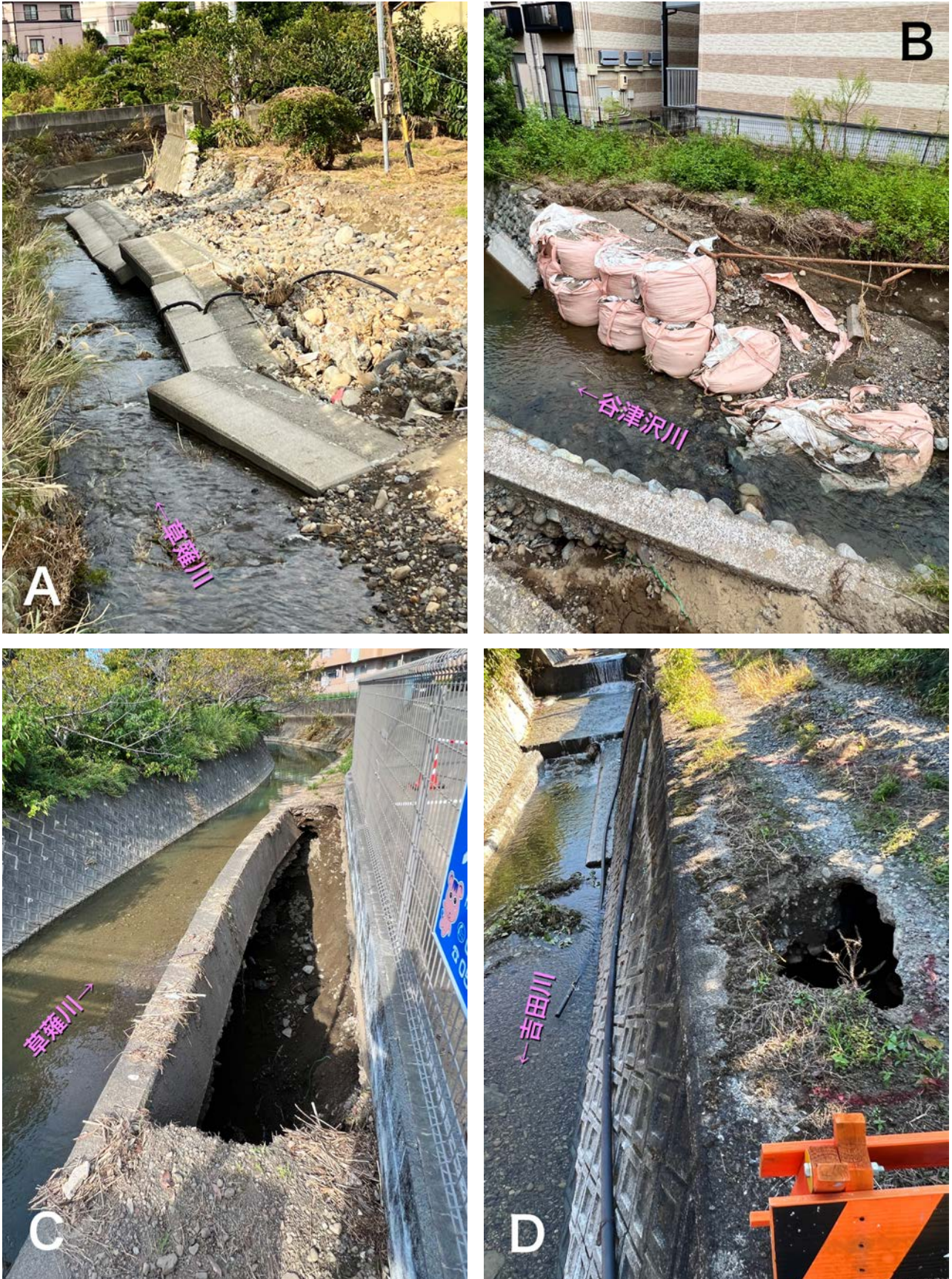
図8 巴川支流における被害の例（洗掘による河岸の崩壊，位置は図2，A～Cの位置は図13Aにも示す）．A：護岸の崩壊（草薙川，2022年9月27日撮影），B：護岸の崩壊（谷津沢川，2022年9月28日撮影），C：河岸の陥没（草薙川，2022年9月29日撮影），D：河岸の陥没（吉田川，2022年9月30日撮影）．
