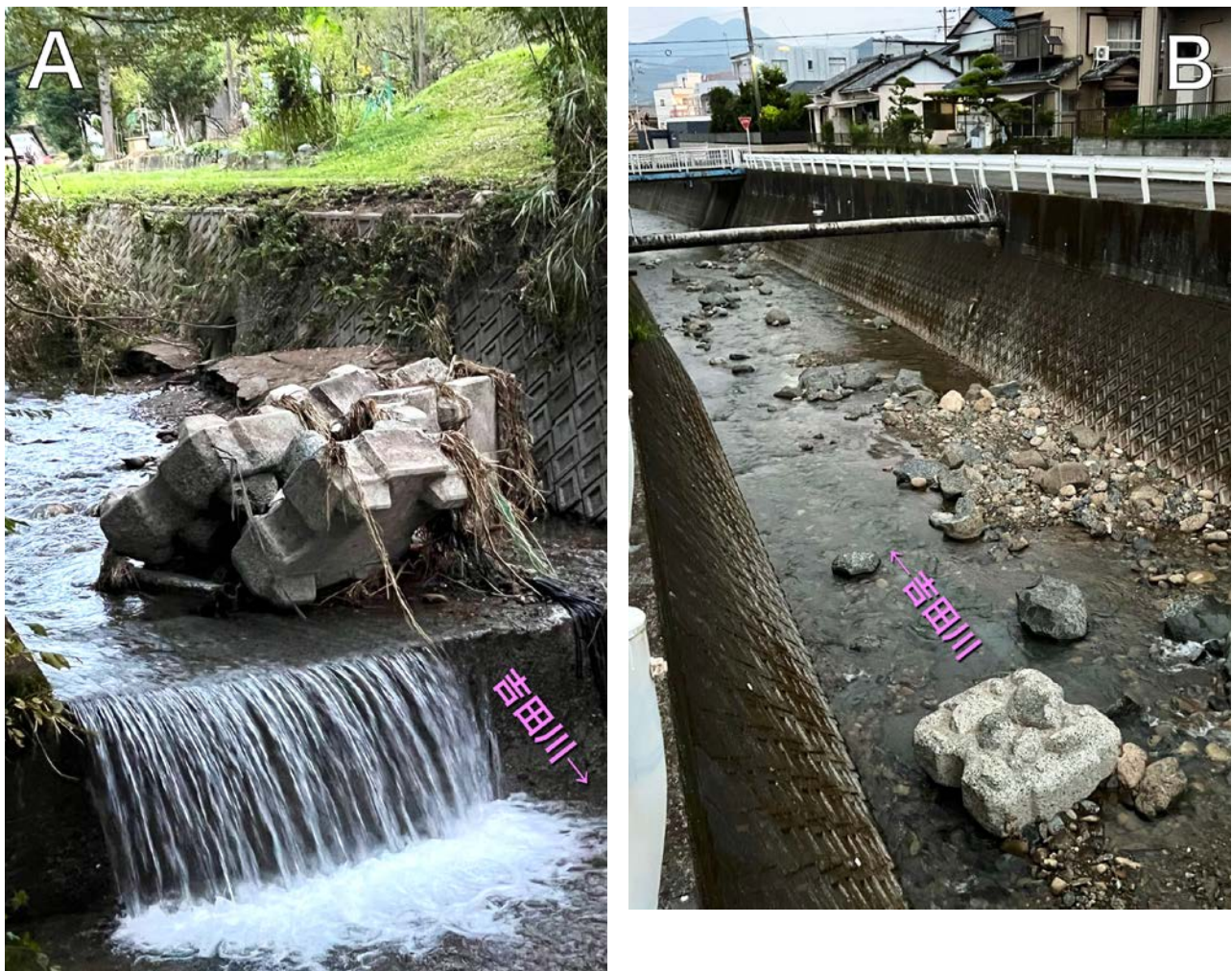
図9 巴川支流における被害の例(吉田川における底固めブロックの流出). A: 流出したブロックの例(2022年9月29日撮影, 位置は図2), B: 下流に流されて池田街道を越える地点に達したブロック(2022年9月29日撮影, 位置は図2と図13A).
