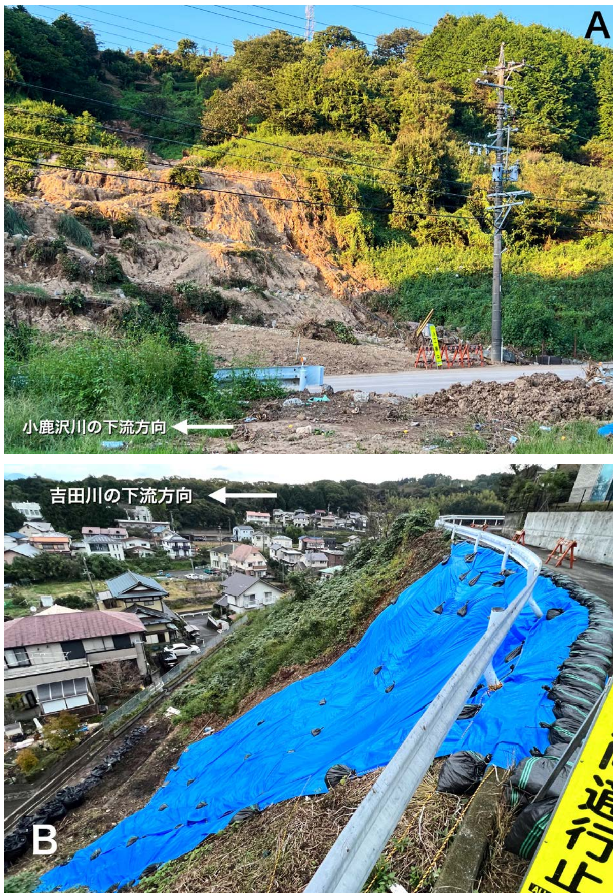
図7 調査地域における斜面崩壊の例。A：小鹿沢川流域（駿河区池田，2022年9月30日撮影，位置は図2），B：吉田川流域（駿河区谷田，2022年10月17日撮影，位置は図2と図13A）。
