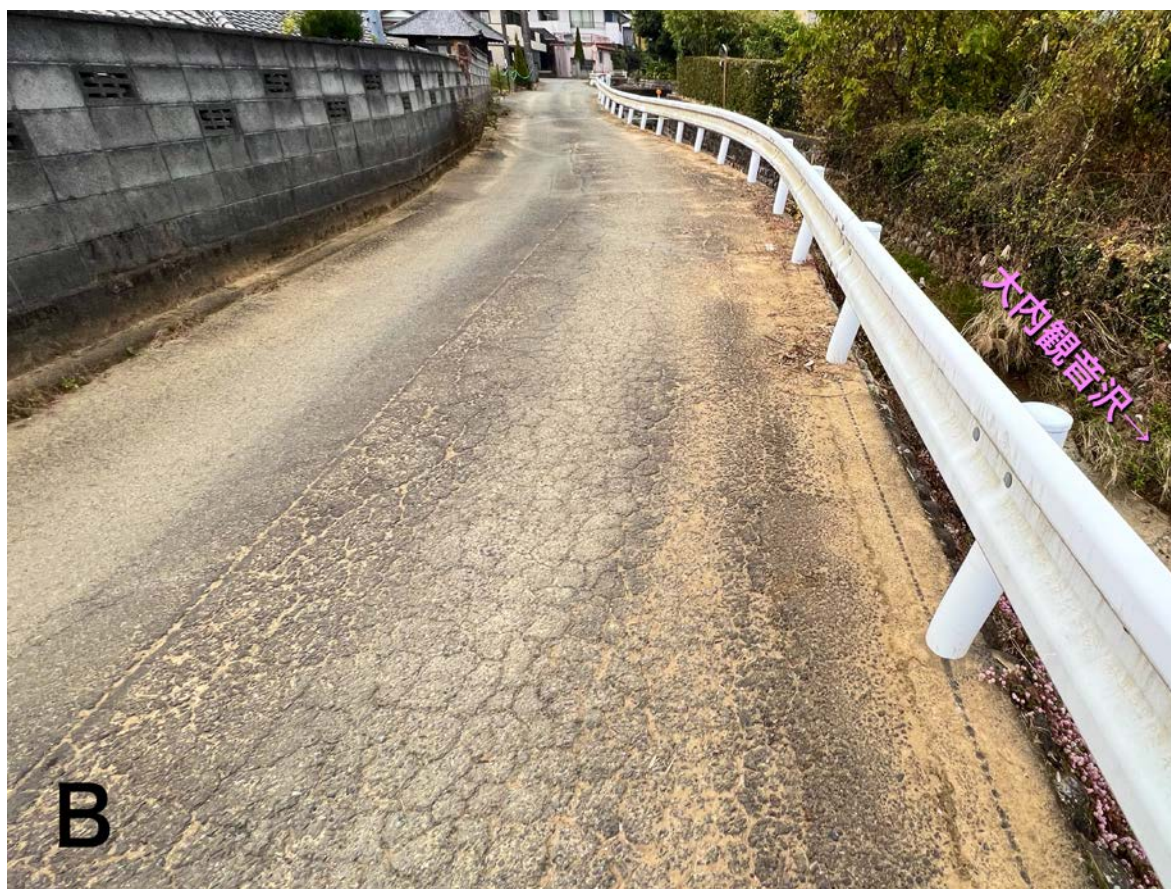
図23 大内観音沢沿いの被害の例（位置は図14A，2022年11月17日撮影）。A：扇状地の扇頂部付近を流れる大内観音沢沿いのブロック塀に残る泥痕（図の赤矢印）。河道わきの市道面（写真右下）よりも高く，越流したことがわかる。B：その下流に沿う市道。道路上の泥痕から全面的に越流したことがわかる。
